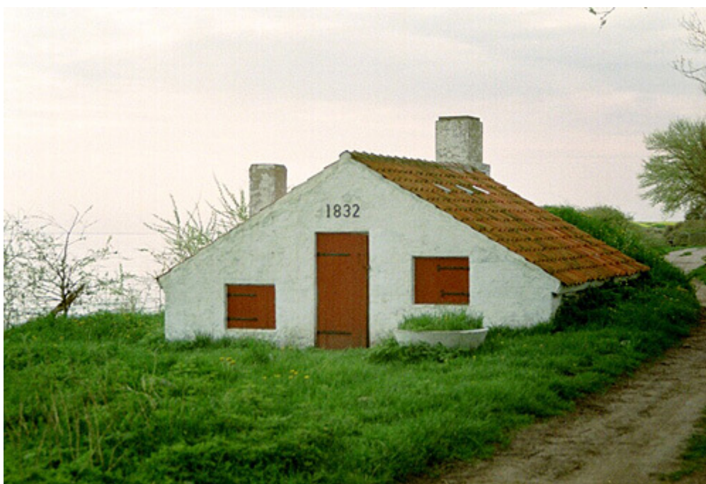
Kalkovnens tilstødende lager og fyrrum set fra nord. Foto: Jørn Enevoldsen, Ballen
